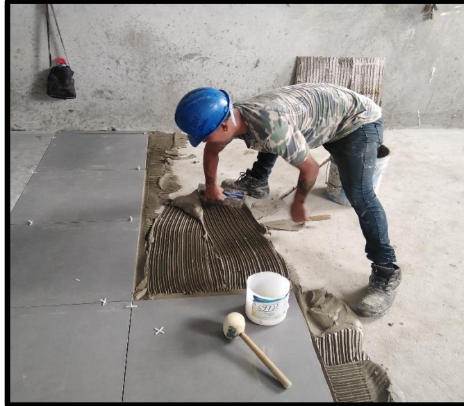
Figura 5: Seguridad en instalaciones de baldosa
