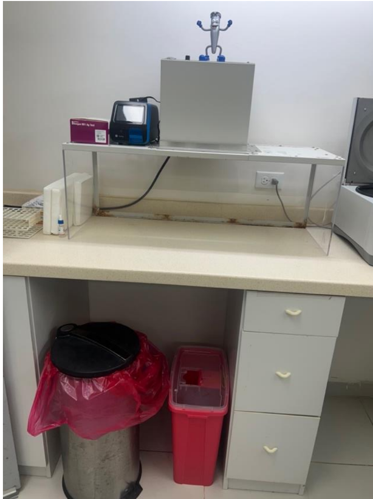
Figura 6. Cámara de bioseguridad inadecuada
