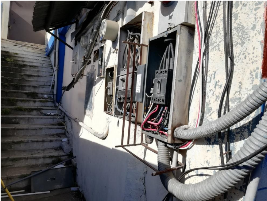
Foto No. 1. Panel eléctrico de la empresa
