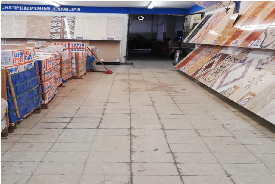
Foto No. 3 y 4 Pisos deteriorados en la empresa
