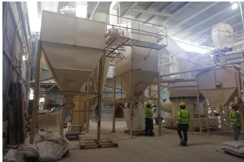
Figura N° 25. Supervisor inspeccionando la maquinaria procesadora de cal
