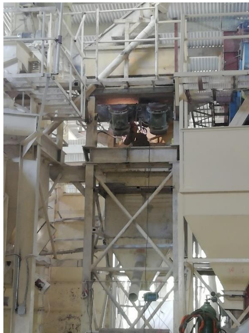
Figura N°32. Soldador no se encontraba anclado.
