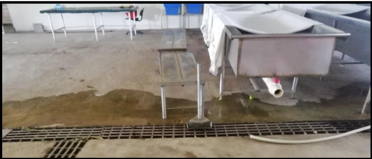
Figura N° 17. Se observa riesgos a caída del mismo nivel (área mojada)
