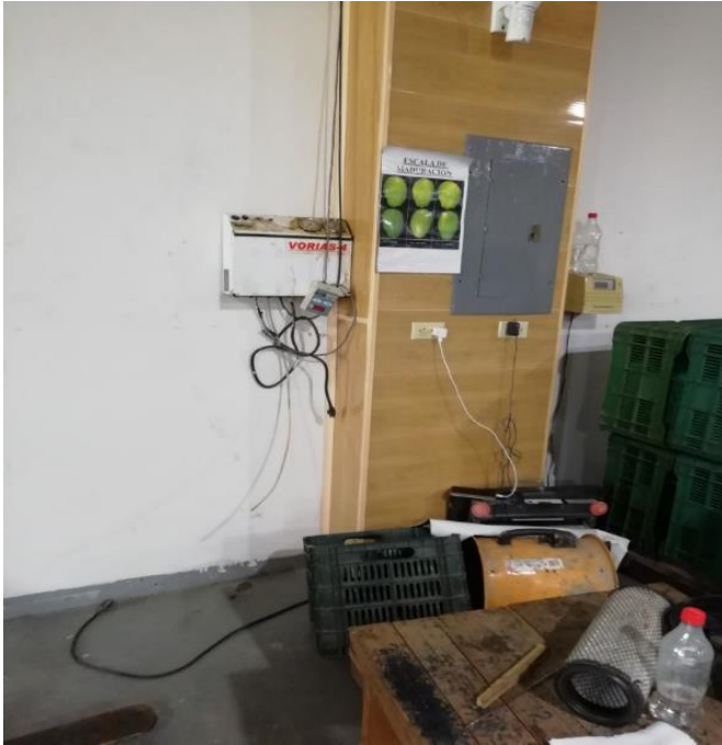
Figura N°22: Se recomienda más orden en esta parte. Cableados correctamente y desconectar los celulares de uso personal
