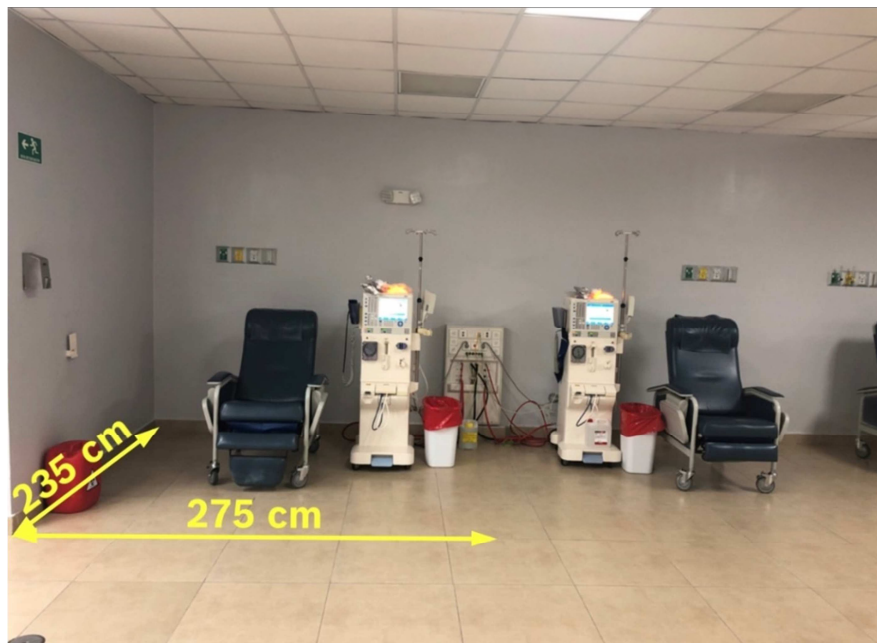
Figura N°2. Distancia entre máquinas, espacios entre unidades de tratamiento de Hemodiálisis en la Sala de Hemodiálisis de Metro 1.
