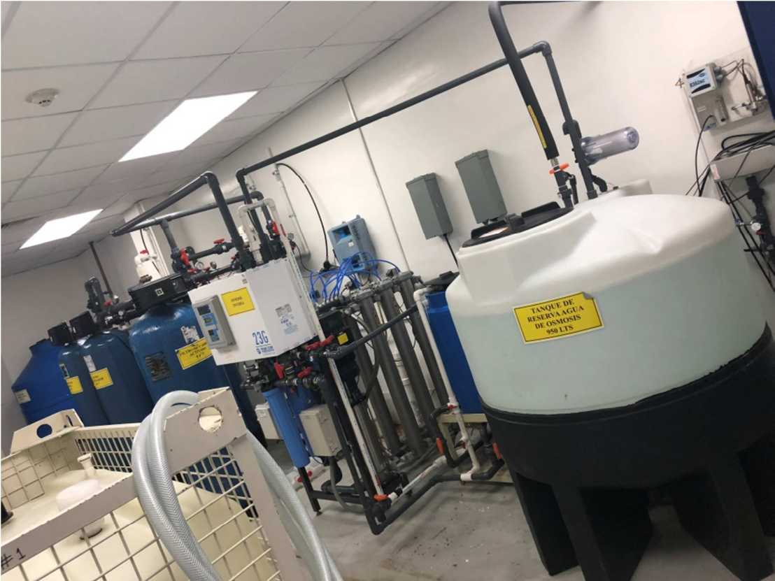
Figura N°5. Planta de Ósmosis Inversa de la Sala de Hemodiálisis de Metro 1.
