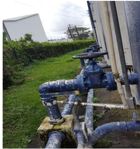
Figura "25": Detalle de la conexión del tanque de agua.
