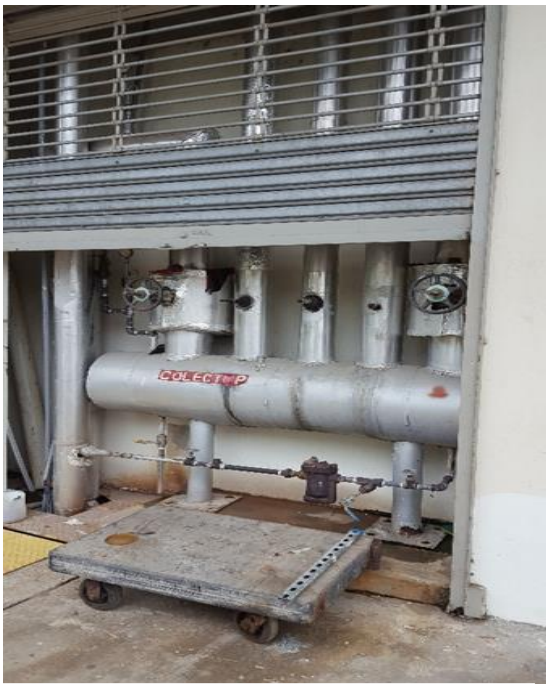
Figura "26": Tuberías Rígidas de los Gases.
