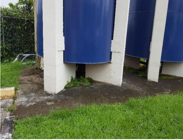
Figura "24": Soportes del Tanque de Agua.
