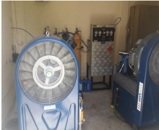
Cuarto de compresores
